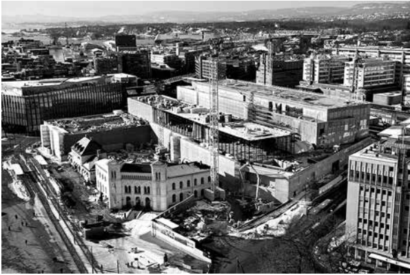
2. Le nouveau Nasjonalmuseet (Oslo) en construction, sur le site de la gare Vestbanen, 2018. Projets de Kleihues + Schuwerk et Rambøll pour le musée, et Østengen & Bergo pour l'environnement du bâtiment.
